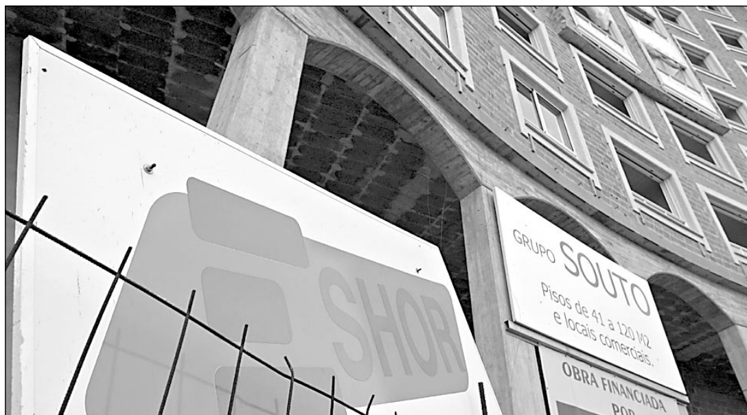
La fabricación y montaje de encofrados para la construcción de estructuras es una de las actividades / Luis Polo
